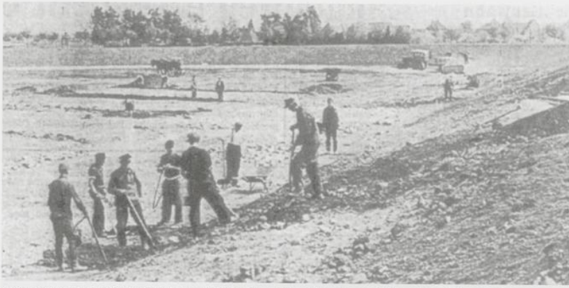
Nicht auf Sand, sondern auf Schutt und Müll gebaut: das Marschwegstadion, Arbeitseinsatz 1948 – Bild: NWZ
