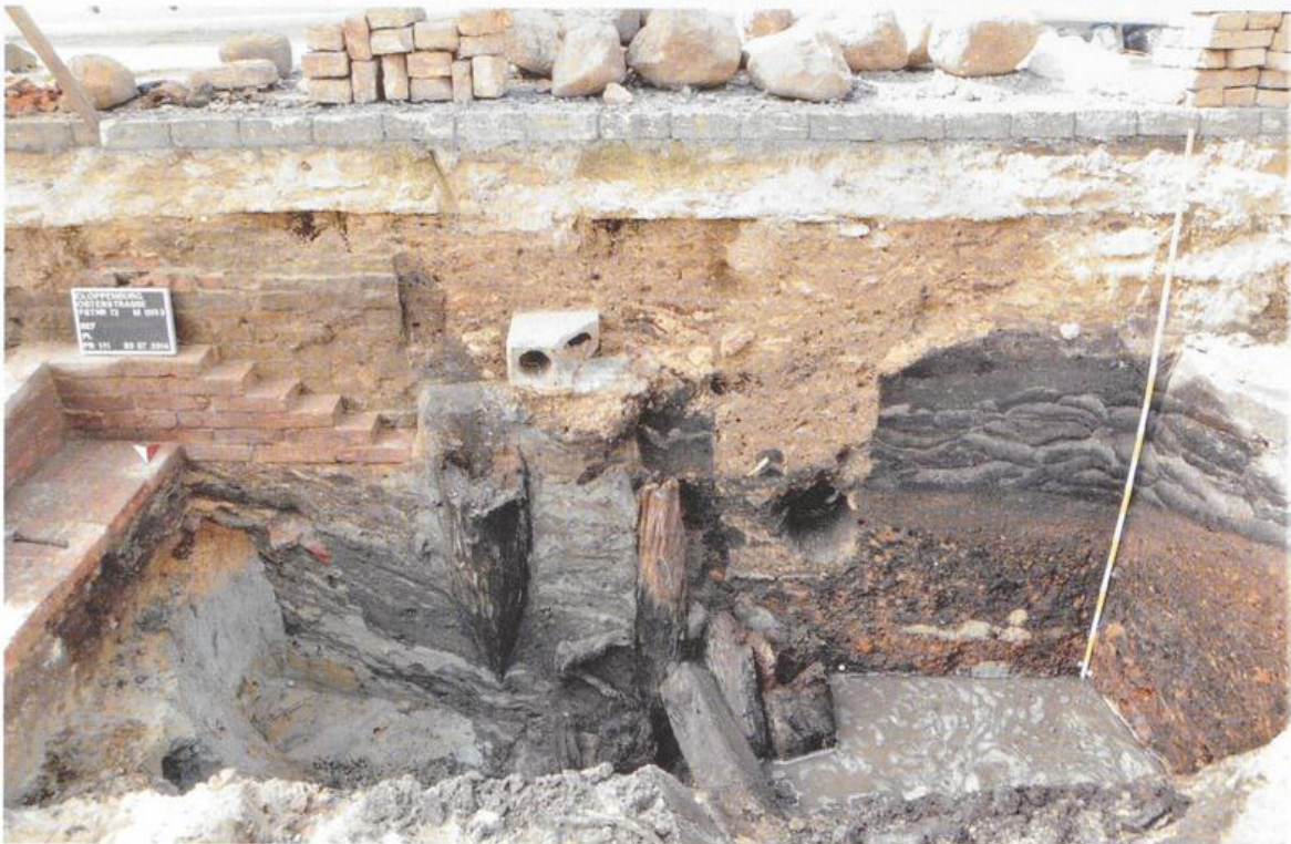
Abb. 6: In der Bildmitte: Doppelpfosten-Fundament der Ratskapelle von 1665. Rechts unterhalb konnte die hölzerne Substruktion des Vorgängerbaus freigelegt werden.
