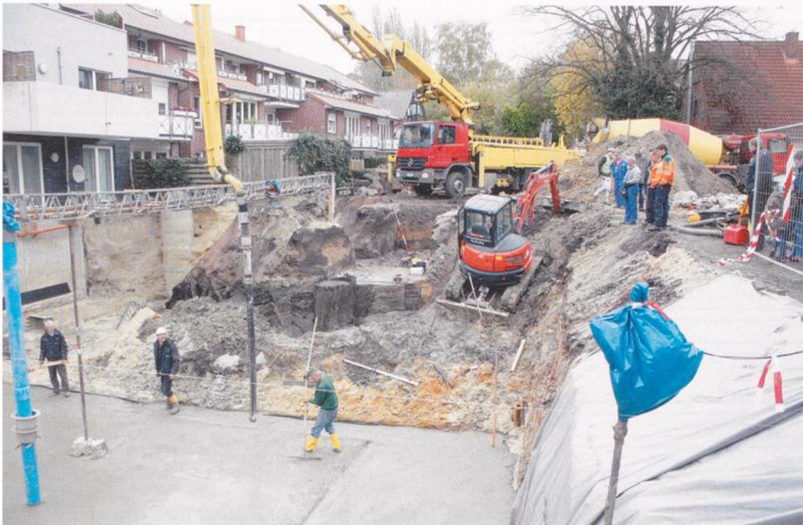
Abb. 9: Stress pur bei einer archäologischen Baubegleitung – Während im Vordergrund bereits die Bodenplatte einer Tiefgarage betoniert wird, läuft parallel die Bergung des Baustammbrunnens an, der seinerzeit am Rand des aufgegebenen Stadtgrabens abgeteuft war (vgl. Abb. 8).
