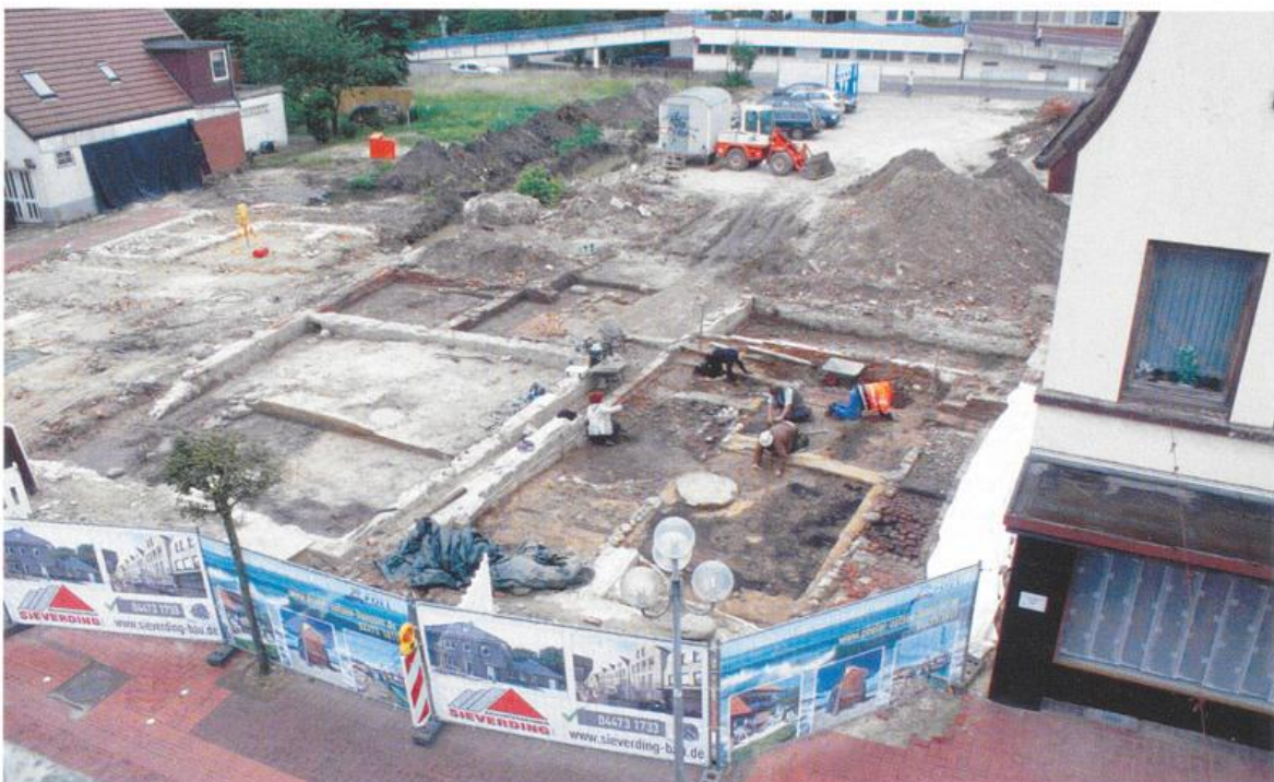
Abb. 4: Typischer Blick auf eine größere Stadtkerngrabung in der heutigen Altstadt von Cloppenburg. Ab 2013 wurde hier ein großes Wohn- und Geschäftshaus samt Tiefgarage errichtet. Zuvor wurden in Handarbeit hunderte Befunde freigelegt.
