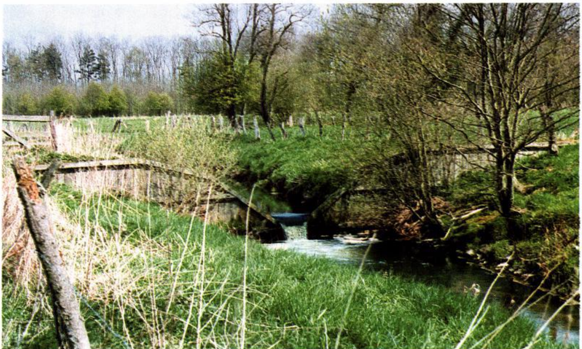
Abb. 4: Dieses Absturzbauwerk wurde durch den Einbau von Bongossispundwänden erstellt. Es ist augenscheinlich, daß eine Wanderung für die im Wasser lebenden Tiere nicht möglich war.
