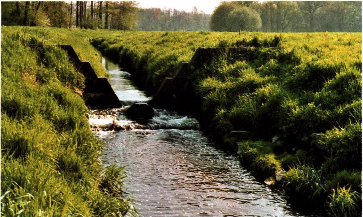
Abb. 3: Auf dem Bild ist ein Absturzbauwerk aus Stahlbeton zu erkennen (System Pfeifenbrink).
