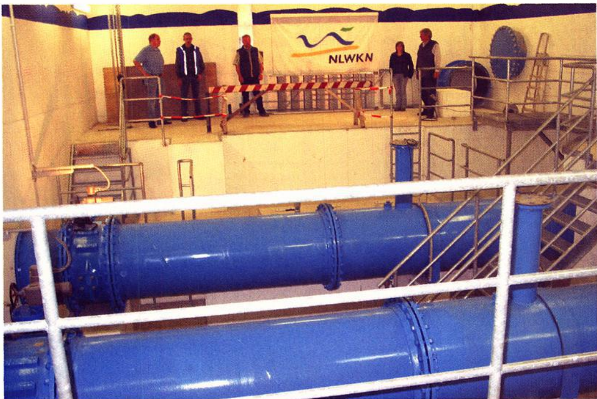
Abb. 3: Technikkeller im Auslaufbauwerk
