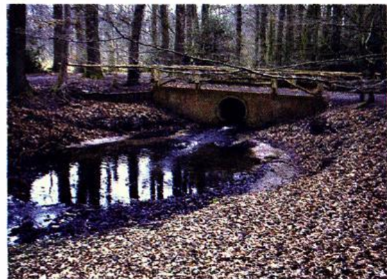
Abb. 3: Rohrdurchlass und Sohlabsturz am Ausbauende verhinderten die Durchgängigkeit des Gewässers.
