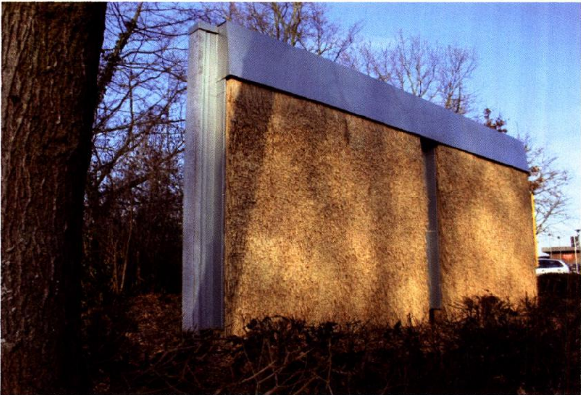
Ökologischer Lärmschutz: Eine Lärmschutzwand aus Reet am Bahnhof Vechta
