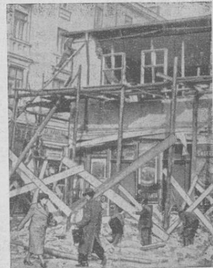
Wiederaufbau nach dem Erdbeben-Ünglück. Ein Haus in Bukarest, das noch die erschreckenden Spuren des Erdbebens trägt, ist bereits mit einem Gerüst versehen worden; die Ausbesserungsarbeiten haben begonnen. (Associated Press.)
