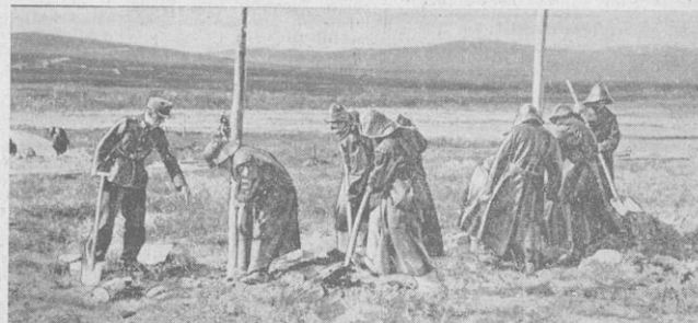
An der Nordostfront, wo der Reichsarbeitsdienst eingesetzt ist, weht ein eisiger Wind, Hagelschauer und Schnee erschweren die Arbeit. Da ist es gut, wenn man sich mit Oelzeug gegen das schlechte Wetter schützen kann. Arbeitsmänner errichten Telegraphenmasten. PK.-Aufnahme: Kriegsberichtler Serr, RAD.
