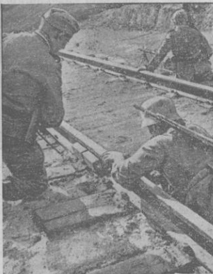
Pioniere sprengen eine Eisenbahnbrücke und machen dadurch einen Transportweg der Sowjets, der für den feindlichen Nachschub wichtig war, unbrauchbar. PK.-Aufn.: Kriegsbericht Weber (HH.)
